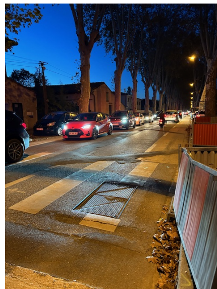
Le remblaiement de la tranchée semble défectueux
